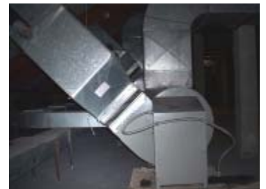
Restroom fan unit.
